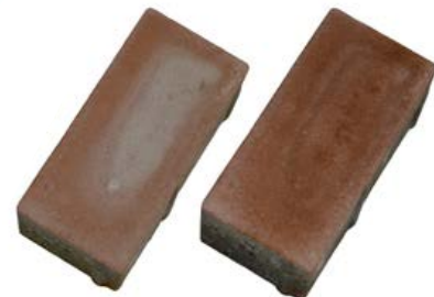
Povrch dlažby s vápenným výkvětem před čišťením a po vyištění Rebanitem S
